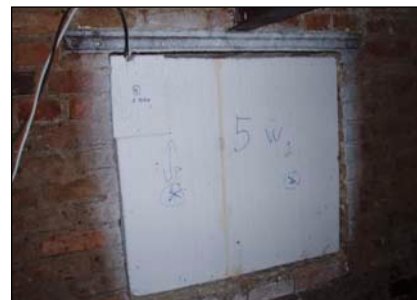
Bild 1: Unzureichende Dämmmaßnahmen im Keller
